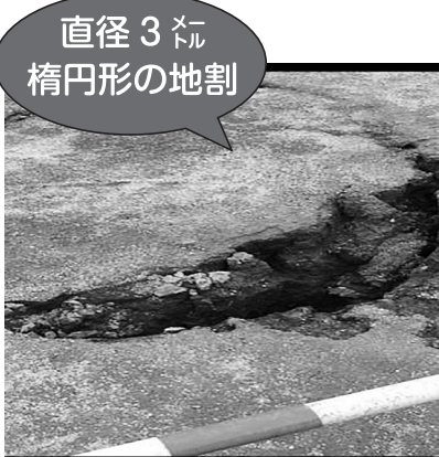
【陥没時の現場】
